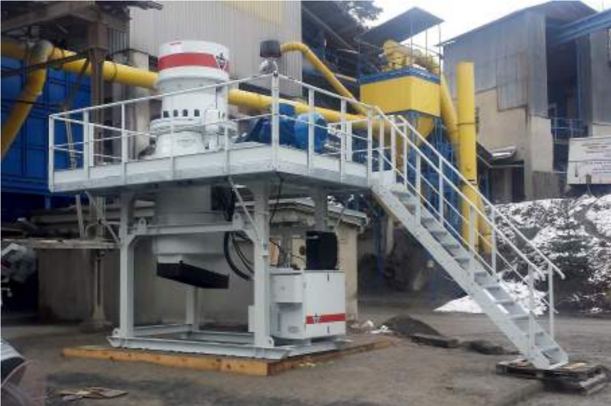
M-Silnice a.s. Hradec Králové – quarry Stašov (Czech Republic) – cone crusher HCU 9/250
