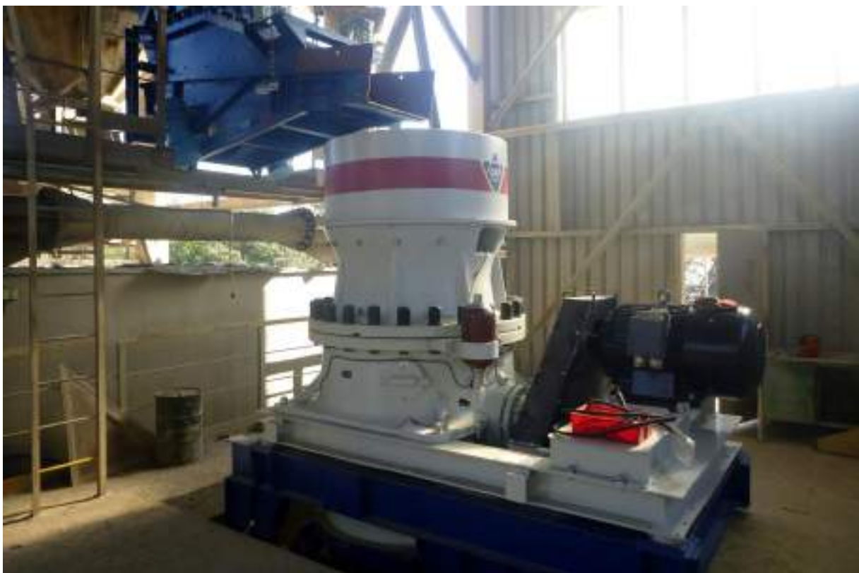
Granita s.r.o. Skuteč – quarry Litická (Czech Republic) – cone crusher HCU 10/90
