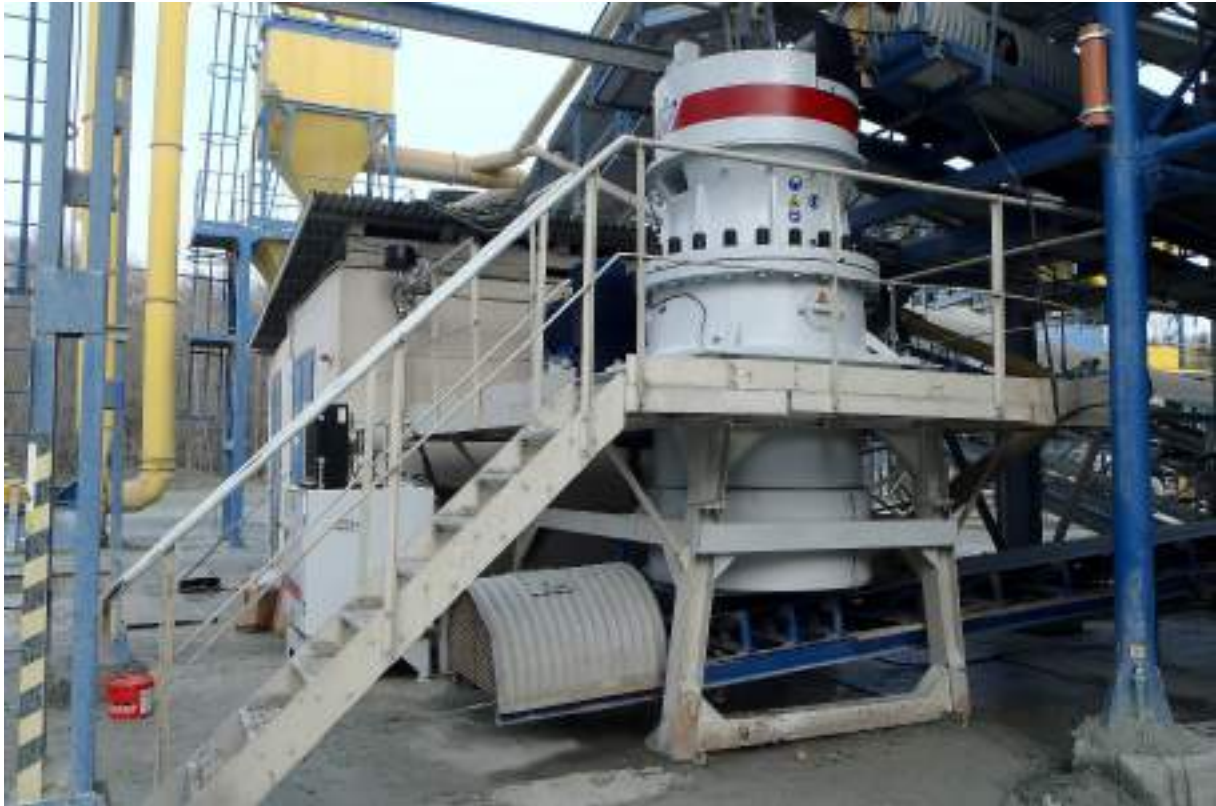
M-Silnice a.s. Hradec Králové – quarry Mastý (Czech Republic) – cone crusher HCU 10/65
